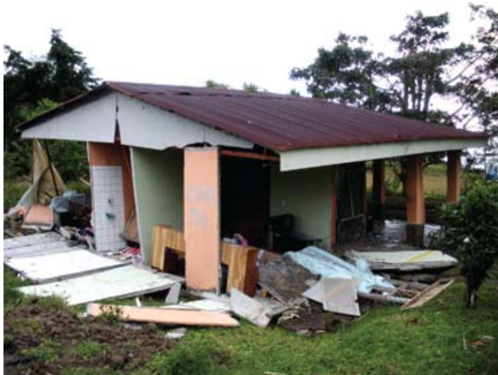
Falla en el sistema de paneles verticales, por falta de un amarre en la parte superior de las paredes
