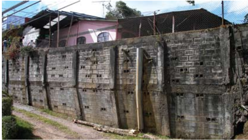
Muro de retención deformado, que amenaza con colapsar.
