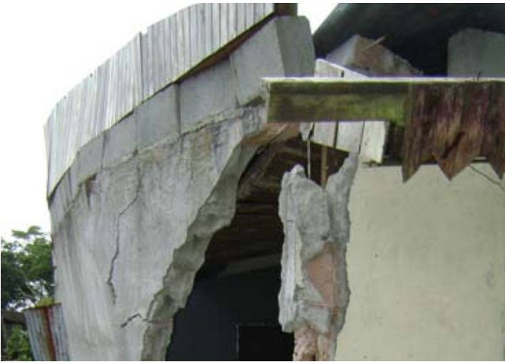
Esquina desintegrada. Nótese la ausencia de acero horizontal así como de la viga corona.
