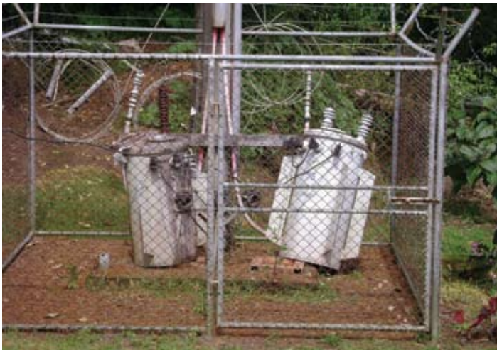
(abajo) Transformadores que no estaban debidamente apoyados.
